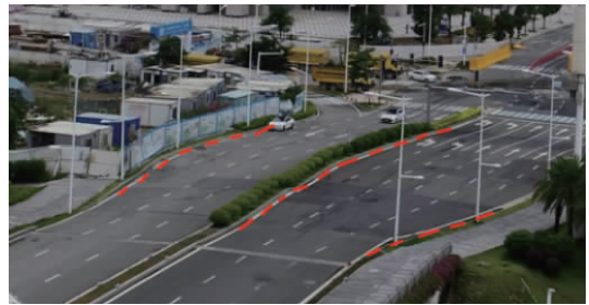
图3 东侧不均匀沉降之实景
